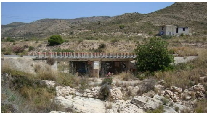
1. Azud semiderruido bajo el puente de la carretera.
