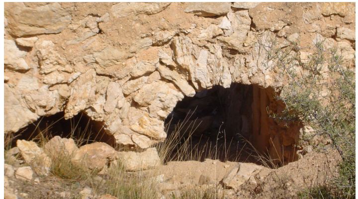
Doble arc en el sistema d'eixida d'aigua
