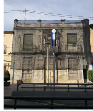
Mal estado de la edificación
